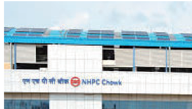
駅舎に設置されたPVパネル
